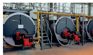
Котельная жилого комплекса с Vitomax HW
