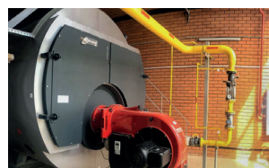
Котельная предприятия по производству сыров с Vitomax HS
