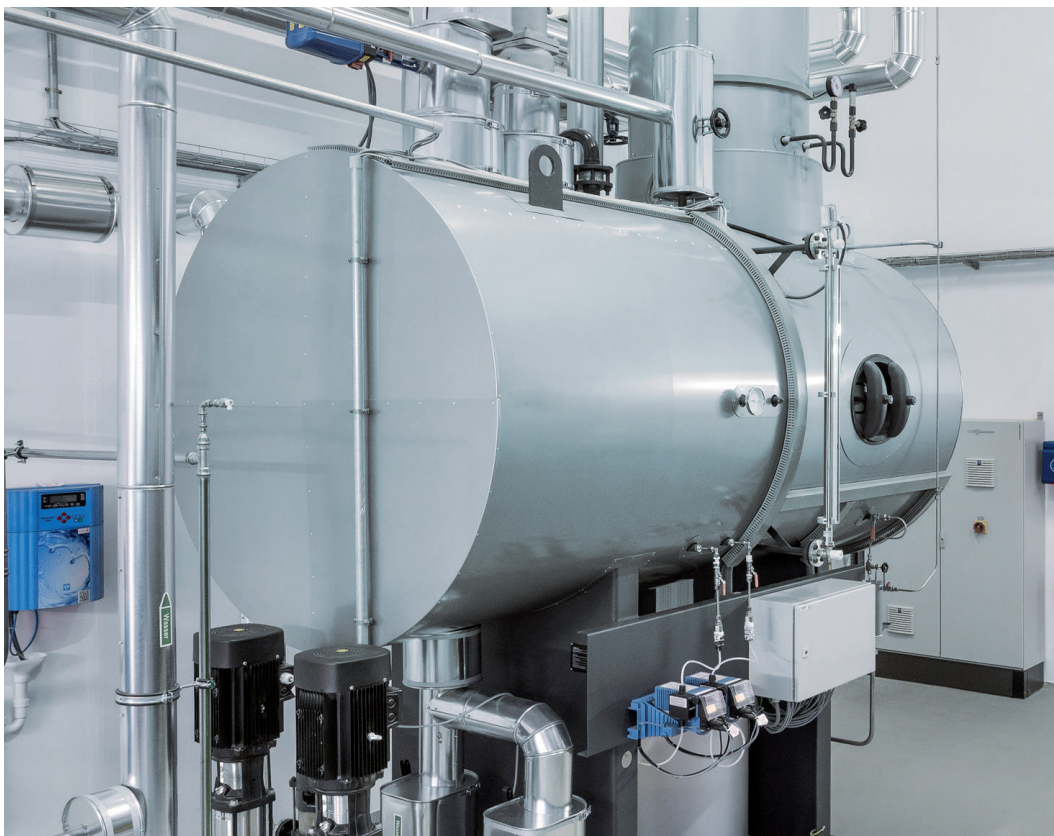
Станция водоподготовки TWA-V
