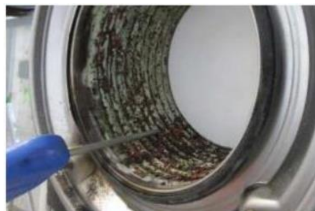
4. Продуть под высоким давлением промежутки между спиралями теплообменника.
