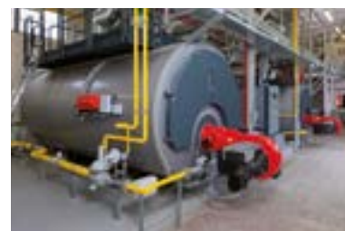
Водогрейный котел высокого давления Vitomax HW
