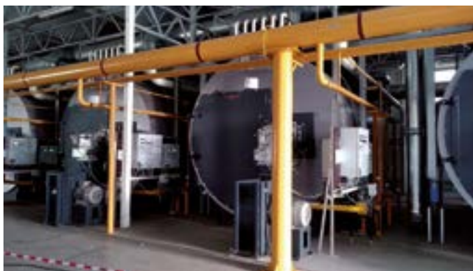
Котельная ТК «Обской» Толмачево
