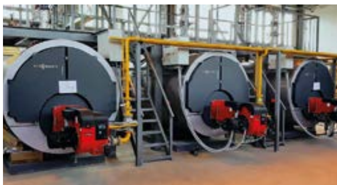
Котельная жилого комплекса г. Новокузнецк
