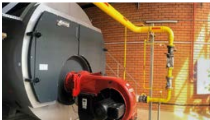
Котельная предприятия по производству сыров «Киприно»
